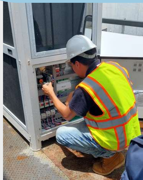
Servicio en un chiller Mecalor
